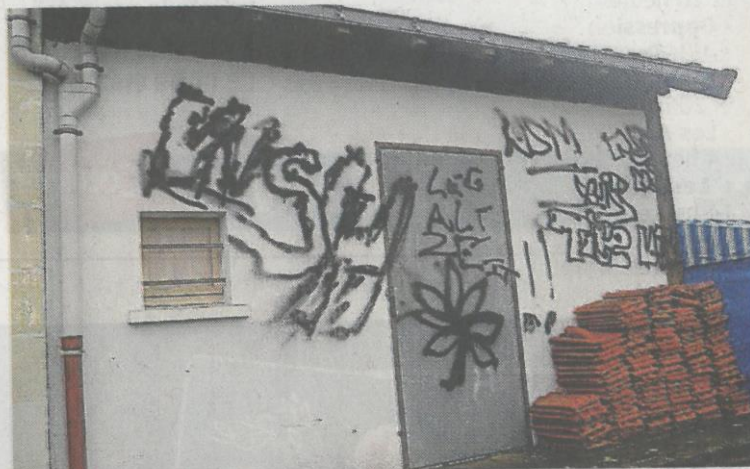
Le mur arrière de l'ancienne gare sur lequel de nombreux tags ont été faits.
