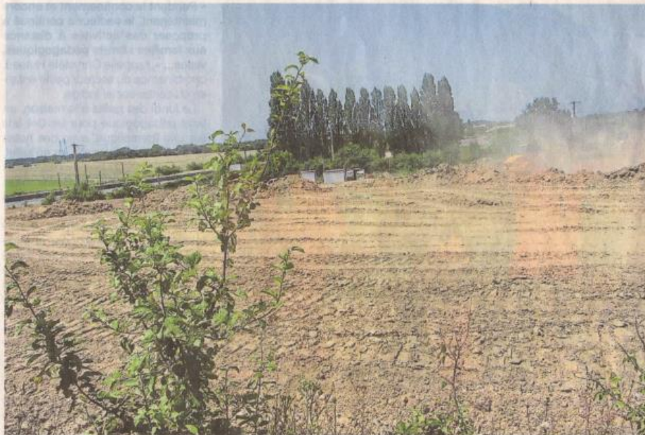
Le terrassement au niveau du rond-point de la Poissardière. Derrière, on aperçoit la RD 752.
